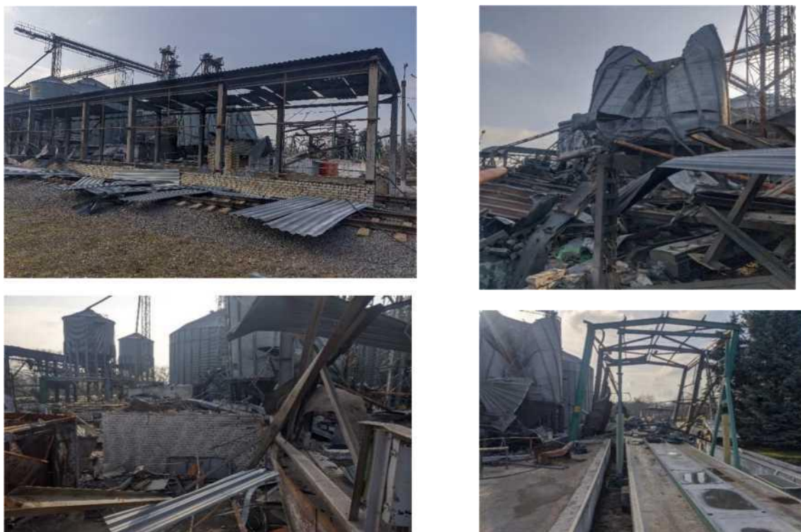
Рисунок 7.2.1 - Фотофіксація зруйнованої території елеватора в с-щі Кільчень
